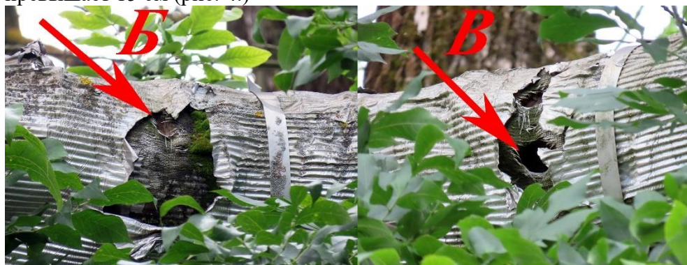
Рис. 4. «Дупла» дятла, нежилое «Б» и занятое на гнездовании наблюдаемыми мухоловками «В» в теплоизоляции теплопровода. Фото Д.В. Кошелева
